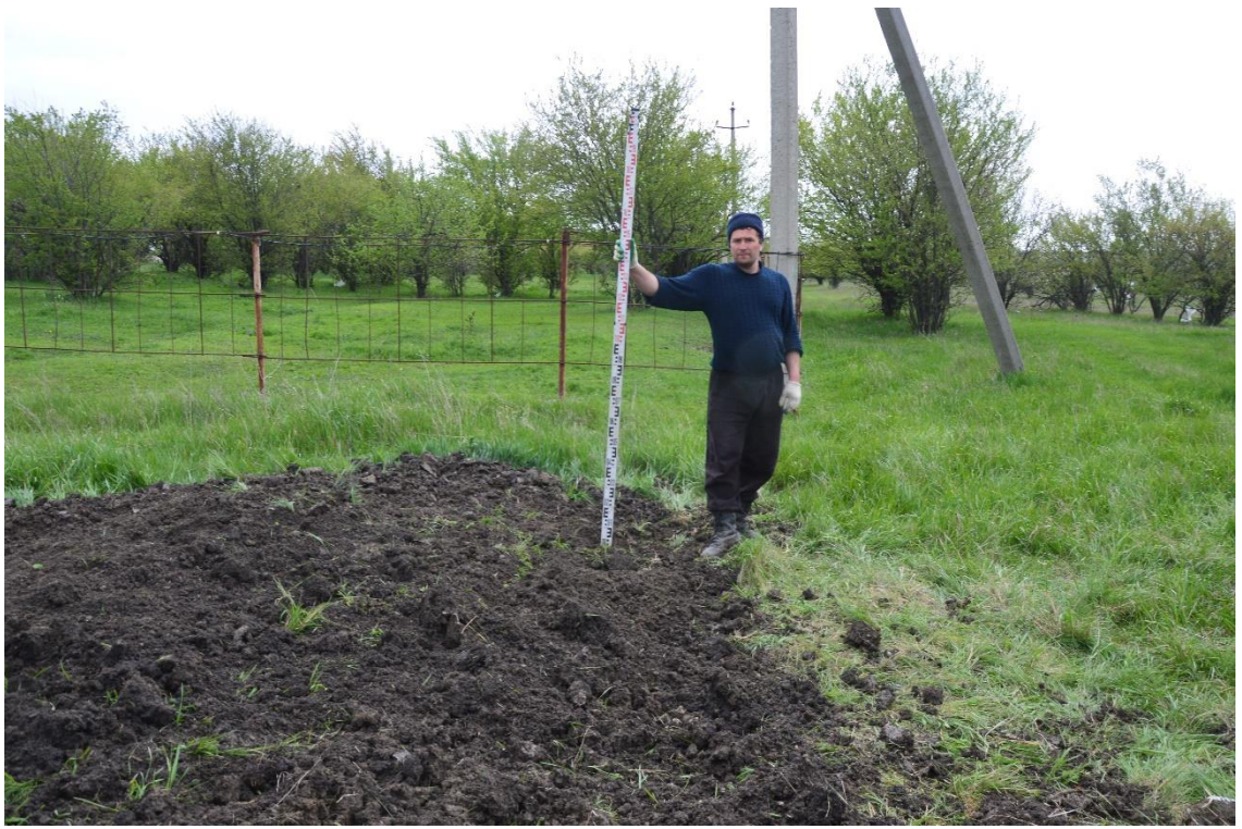
Рис. 104. Археологические исследования в зоне проектирования двухцепной воздушной линии 10 кВ от I и II СШ РУ 10 кВ ПС 110 кВ «Садовая» через село Чапаевское протяженностью 9 км. Шурф № 7. Рекультивация. Вид с Ю.
